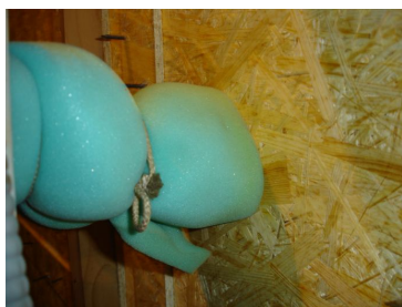
Fig. 6.2 – Izolarea fonică cu material special tip burete (grosime 20mm) a zonei de trecere a conductelor de la unitatea interioară la cea exterioară
