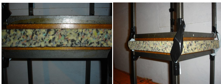
Fig. 6.3 – Izolarea structurii de montaj de grilajul existent pe podeaua camerei anecoice cu material vibro-izolator tip burete de grosime 50mm
