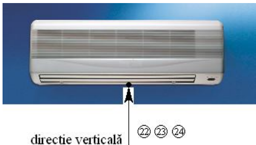
Fig. 5.6 – Locația nr.2. Amplasarea punctelor de măsură pentru înregistrarea vibrațiilor pe unitatea interioară
